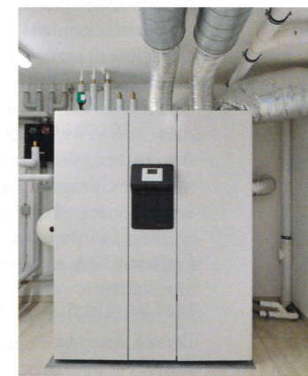
Förderungswürdig: Die Luft-Wasser-Wärmepumpe ist eine der Komponenten, die Life zum Effizienzhaus 40 Plus macht.
