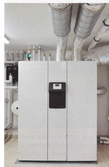
Förderungswürdig: Die Luft-Wasser-Wärmepumpe ist eine der Komponenten, die LIFE zum Effizienzhaus 40 Plus macht.
